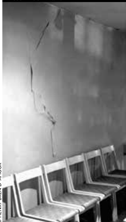
Alte Dorfkirche: Die Empore, Risse in der Wand
